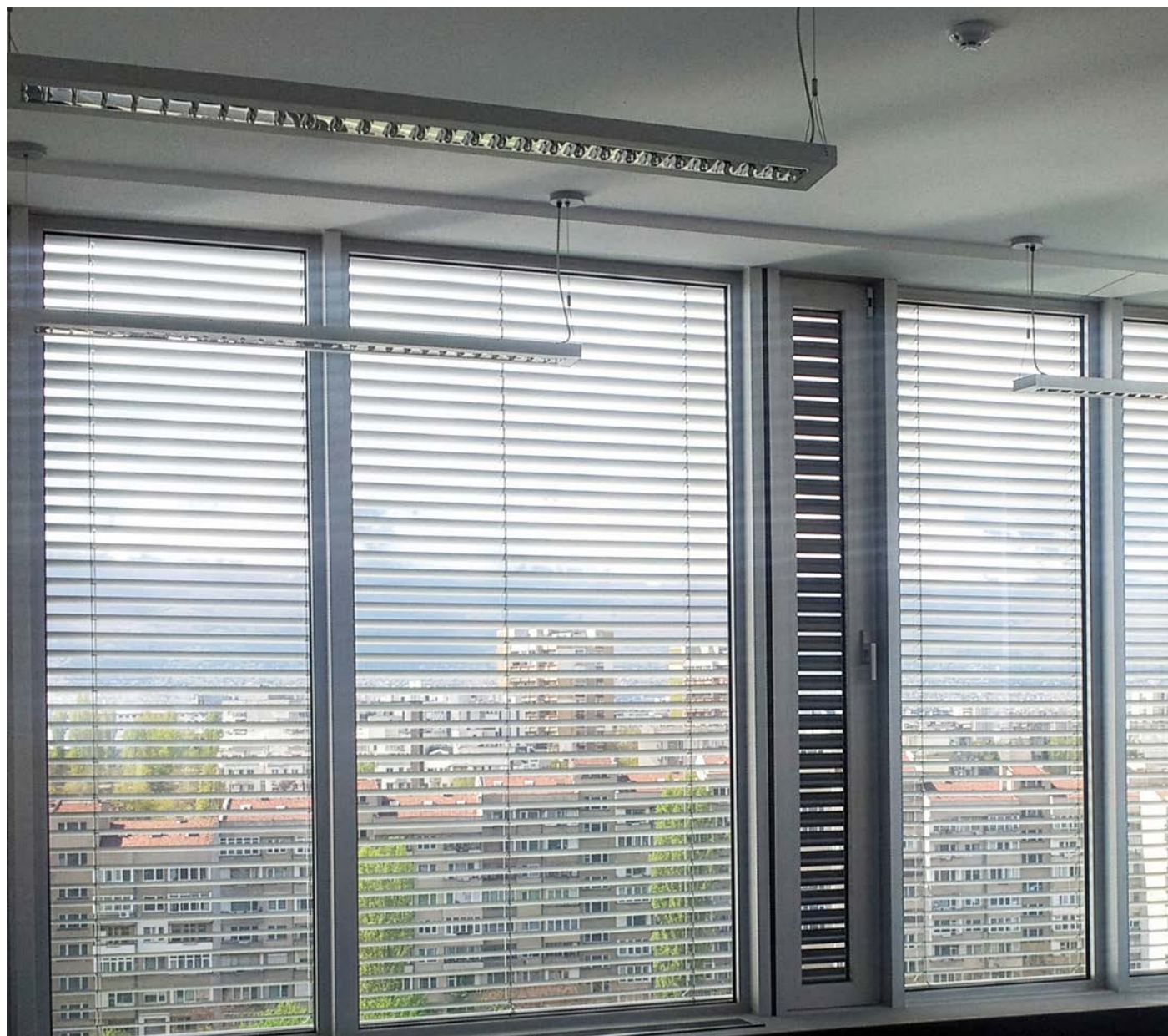
Abbildung 4: Die »Retroflex«-Lamellen verbinden Durchsicht, Sonnenschutz und Tageslichtlenkung. Durch die gezielte Umlenkung des Tageslichts an die Decke kann eine Tageslichtversorgung bis in 7,5 m Raumtiefe erreicht werden.
